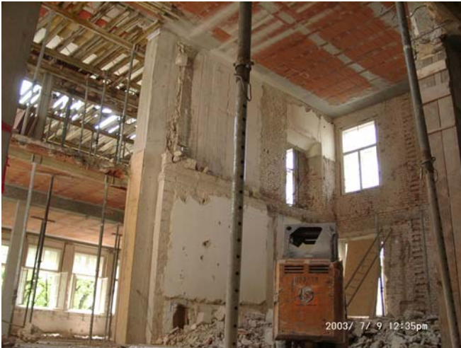
Bauzustand: Ausbruch für Deckenaustausch
